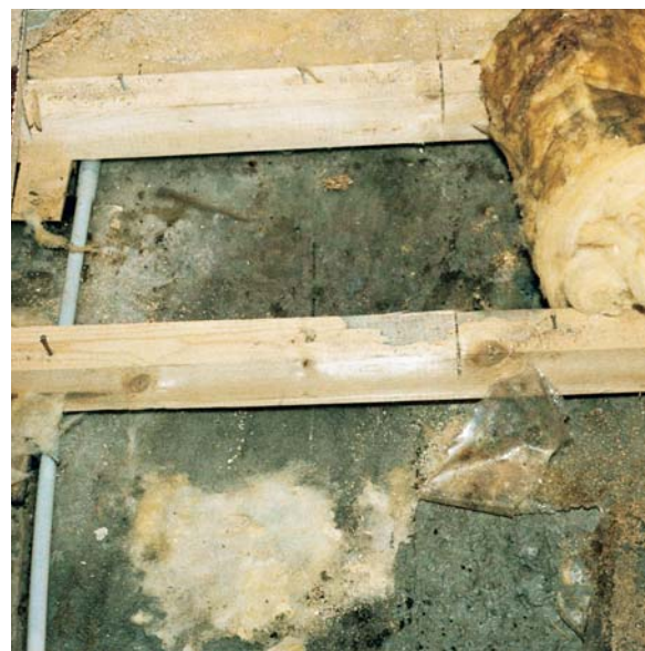
Maakosteus on siirtynyt betonin/rakennusmuovin läpi ja synnyttänyt homekasvustoa.
