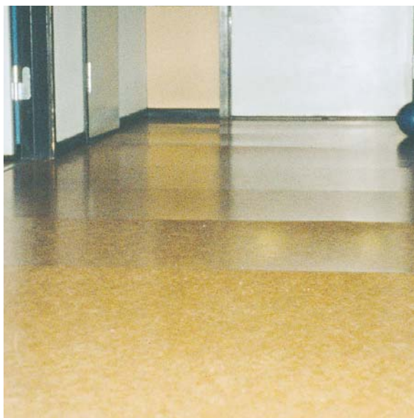
Betonilaatasta lattianpäällysteeseen päässyt kosteus on turvottanut maton saumat ja hajottanut liiman koostumuksen, minkä vuoksi muovimaton alle on syntynyt ilmakuplia.
